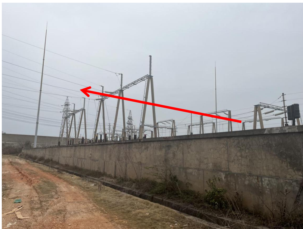
图 2.8 梅林变扩建间隔侧照片
